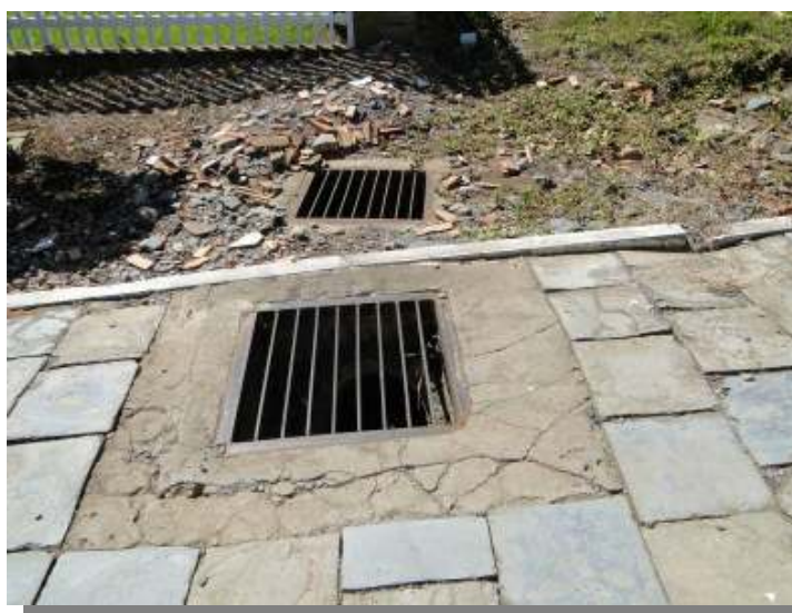
Figura 28: Boca de Lobo tipo grelha. Fonte: Visita Técnica STE, 2010.
