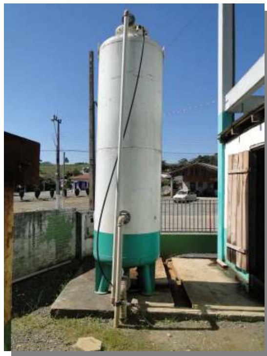
Figura 5: Filtro. Fonte: Visita Técnica STE, 2010.
