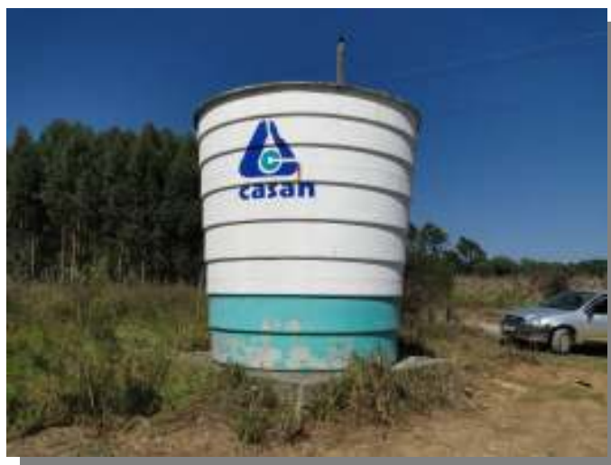
Figura 9: Reservatório de água. Fonte: Visita Técnica STE, 2010.
