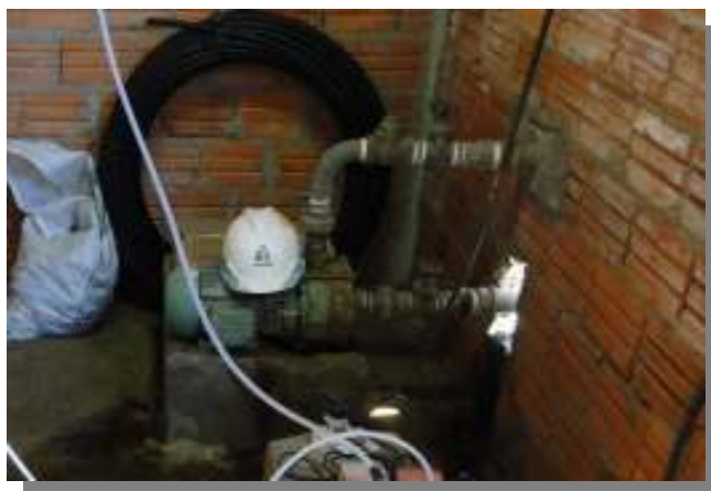
Figura 8: Elevatória de água tratada. Fonte: Visita Técnica STE, 2010.
