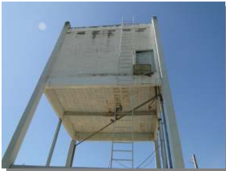
Figura 10: Reservatório de água. Fonte: Visita Técnica STE, 2010.
