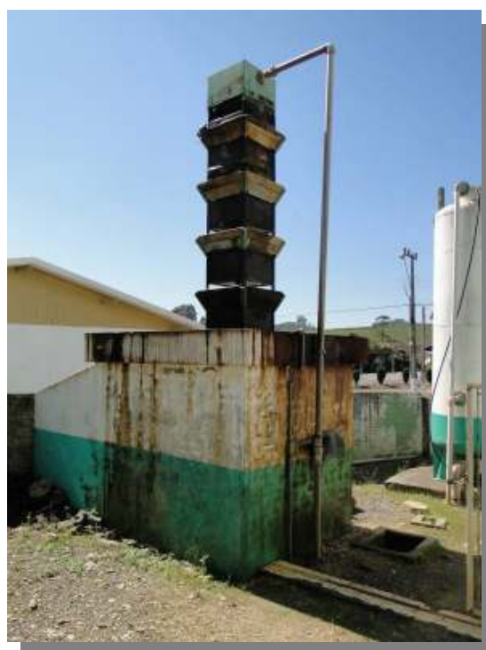
Figura 6: Aerador. Fonte: Visita Técnica STE, 2010.
