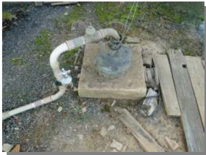
Figura 4: Captação de água bruta – poço profundo. Fonte: Visita Técnica STE, 2010.
