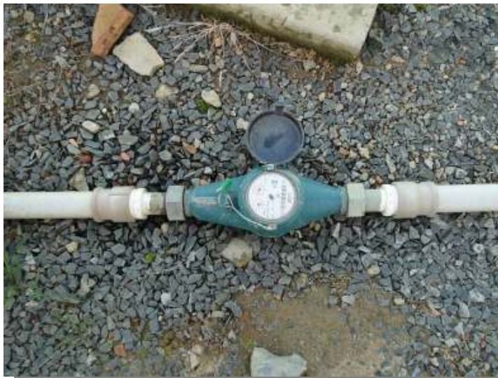
Figura 11: Macro-medidor. Fonte: Visita Técnica STE, 2010.
