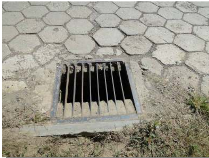
Figura 27: Boca de Lobo tipo grelha. Fonte: Visita Técnica STE, 2010.
